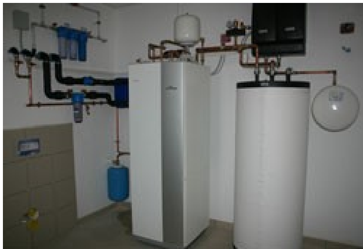
Slika 9.2: Toplotna črpalka s hranilnikom toplote.
